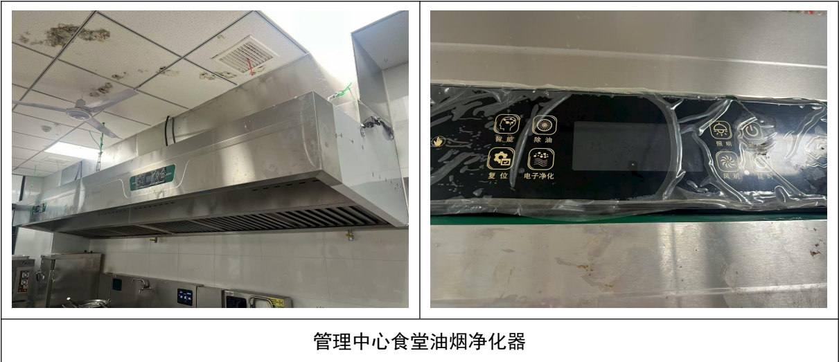
图 7.2-1 运营期大气污染防治设施照片
