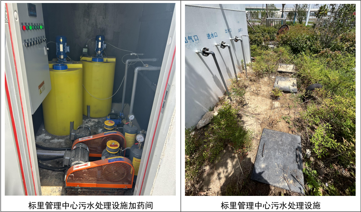
图 8.3-4 污水处理设施照片
