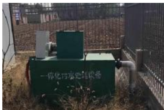
BMTJ-02 标项目部污水处理设施
